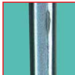
Corrosión de contacto: Acero inoxidable/latón
