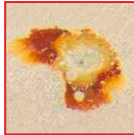
Ejemplo de corrosión de picadura
